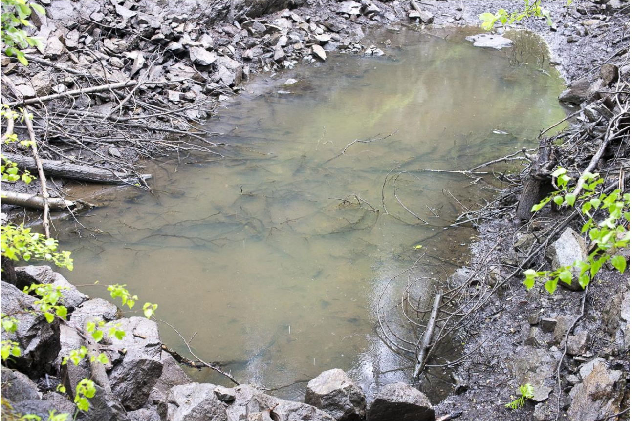
Kulp på sørsiden av steinfyllinga
