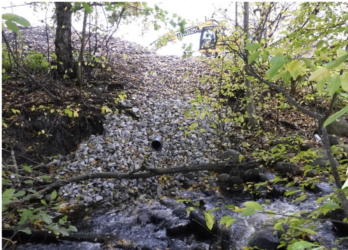
Et firma har lagt et overvannsrør i gtov pukk helt inntil Kjøsterudbekken øverst i meanderdalen. Vannmiljøutvalget har meldt fra om dette til Drammen kommune som et ulovlig tiltak, men vi har ikke fått svar. Foto: John Tollefsen
