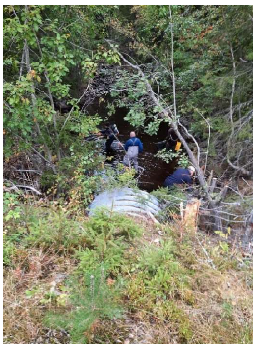
Kulp på oversiden av veien. (Foto: Jan I. Larsen)
